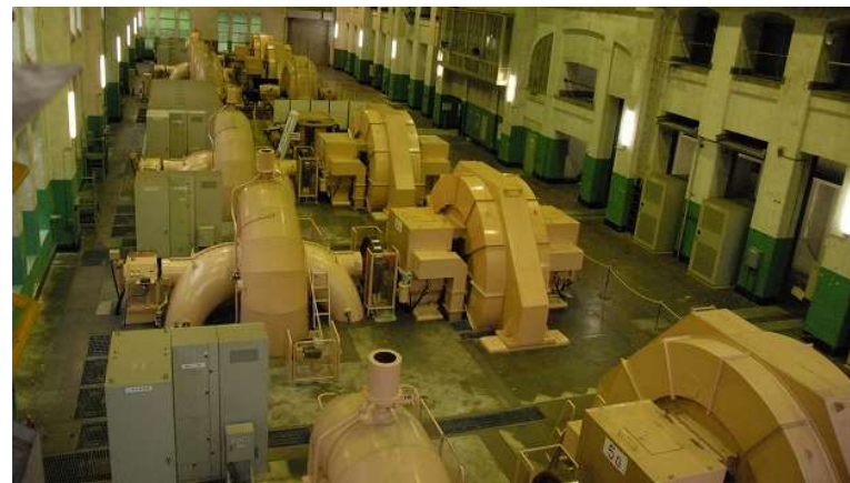
発電設備（水車と発電機）
